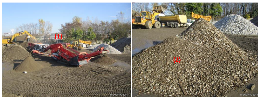
Vue d'ensemble de l'installation en série concasseur-cribleur (1) / Vue de détail du refus (fraction > 10 mm) (2)
