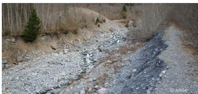
Digue en rive gauche largement dégradée
