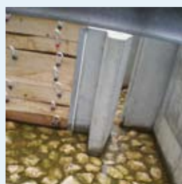
Vue des bassins et des rugosités de fond (intérieur de la passe)
