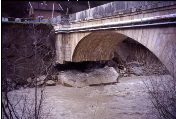
Déstabilisation du Pont des Chaînes en décembre 2003 (photo FL)
