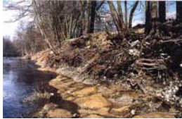
Etat des berges
