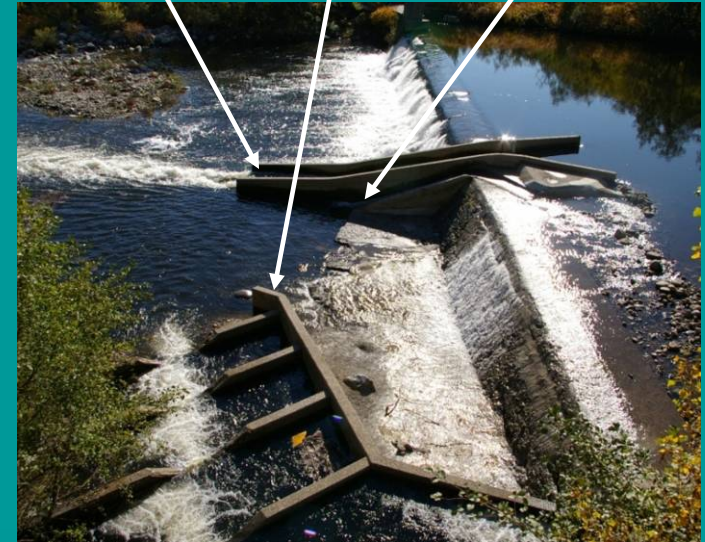
L'Ardèche à Labégude Passe CK + passe bassins + rampe à anguille
