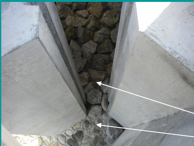
Absence ou insuffisance de substrat rugueux
