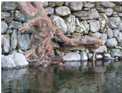
la souche de l'arbre doit être extraite et l'ouvrage réparé
