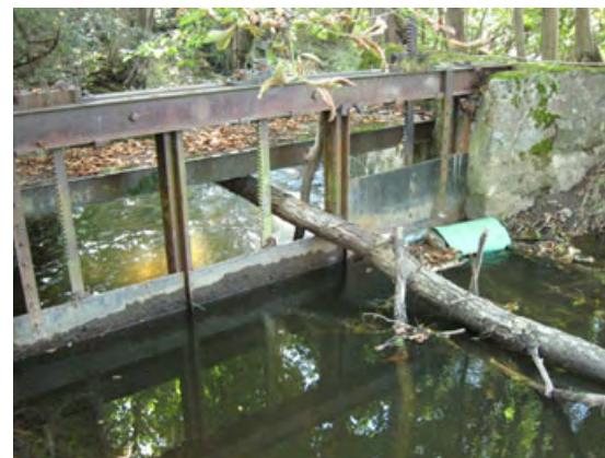
Blocage de bois dans une prise d'eau.
