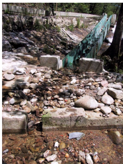
engravement d'une passe à ralentisseur après une forte crue : un nettoyage manuel de l'ouvrage est nécessaire.
