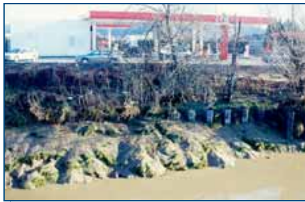
Figure 50 : Exemple de formation de « ravines » en berge dues à un profil trop raide en présence de contraintes de marées (ici la Garonne en ville de Bordeaux avec des ouvrages de renforcements de berge en palplanches). ≈
