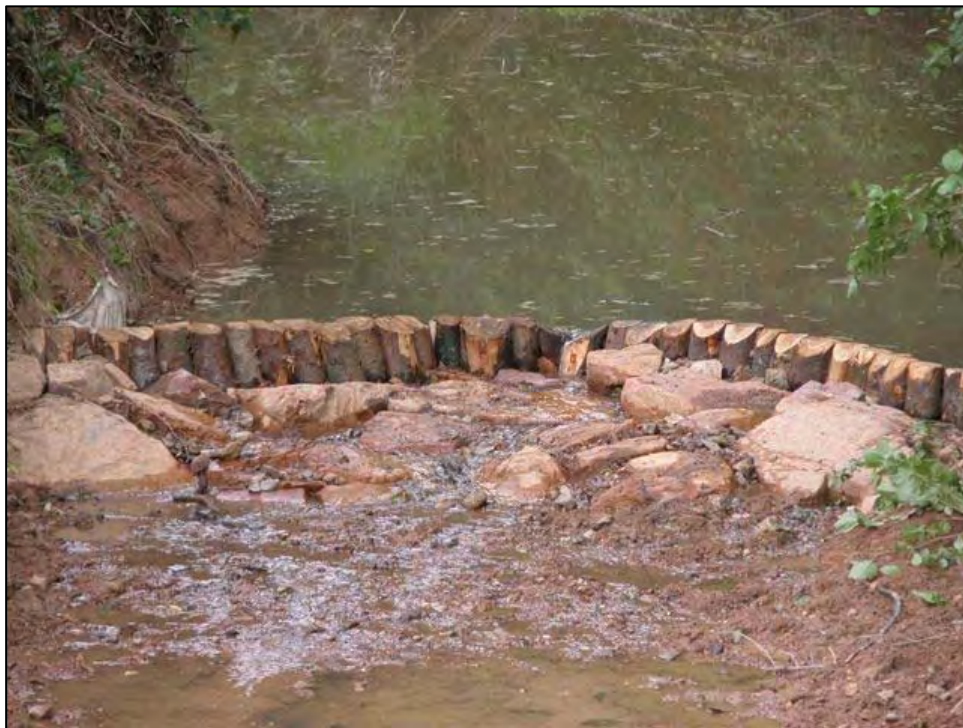
Partie aval de l'ouvrage avec un radier en enrochements (Source : C.C. Pays de Charlieu)
