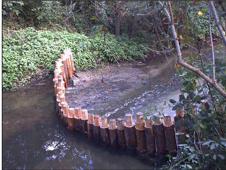
Pieux battus mécaniquement à l'aide d'une cloche de battage pneumatique montée sur un brise roche hydraulique (Source : Syndicat Lignon)
