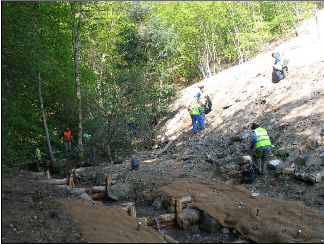
Fin du chantier. Le lit est corrigé, les berges sont reprofilées et revégétalisées (Source : SMAGGA)
