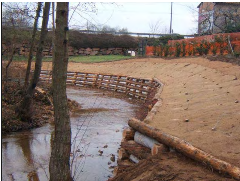
Caisson terminé. Le remblai supérieur est protégé avec une toile de coco. On peut observer les boutures de saules plantées en partie supérieure de l'ouvrage dans la toile de coco. (Source : C.C. Pays de Charlieu)
