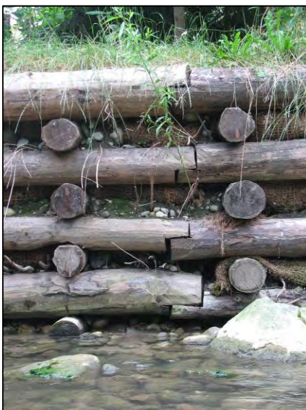
Assemblage des longrines avec coupes à mi-bois. On remarque l'alignement vertical des jonctions et des moises. (Source : MATRINGE, 2008)
