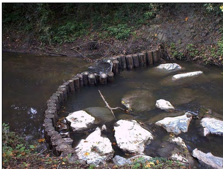
Pieux de l'ouvrage en cours de déchaussement (Source : syndicat Lignon)
