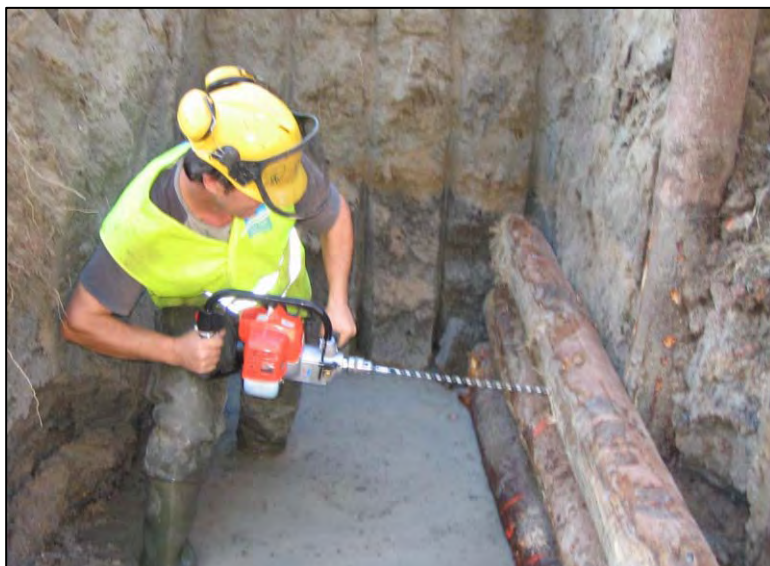
Avant-trou pour fixation des troncs transversaux aux pieux (Source : Département du Rhône, Brigades Vertes)
