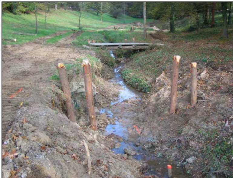
Implantation des quatre pieux à l'aval des troncs transversaux (Source : Département du Rhône, Brigades Vertes)
