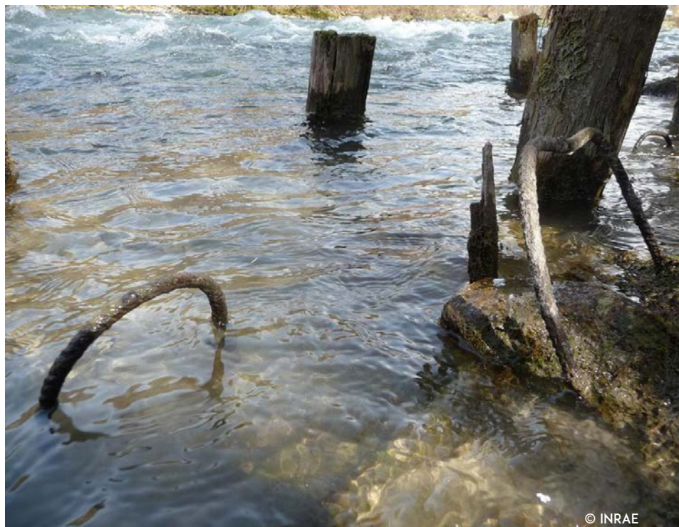
Ferrailage restant au droit d'un ouvrage de génie végétal dégradé
