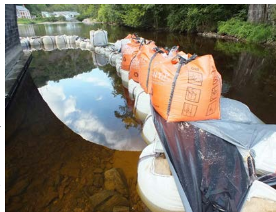
Échec du batardeau en 2013
