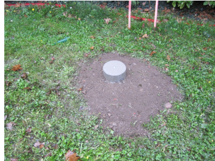
Mise en place de repères topographiques pour suivre le tassement de la digue (octobre 2012)
