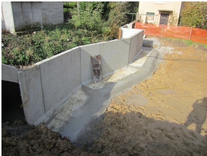
Fondations du mur digue en béton armé en amont de la future passerelle (novembre 2012)
