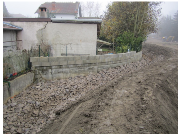
Détail du fossé drainant et problème de fissuration des murs riverains (novembre 2012)
