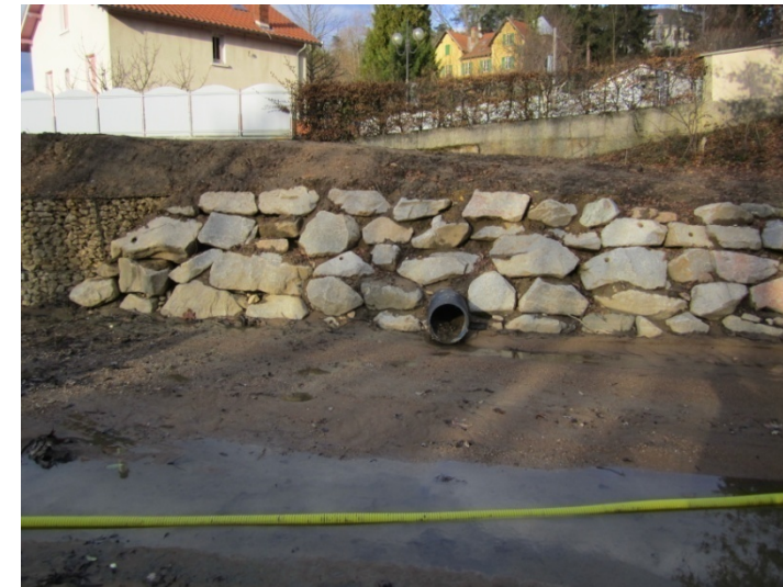
Sortie du drain de collecte des eaux derrière la digue (en attente pose clapet anti retour)
