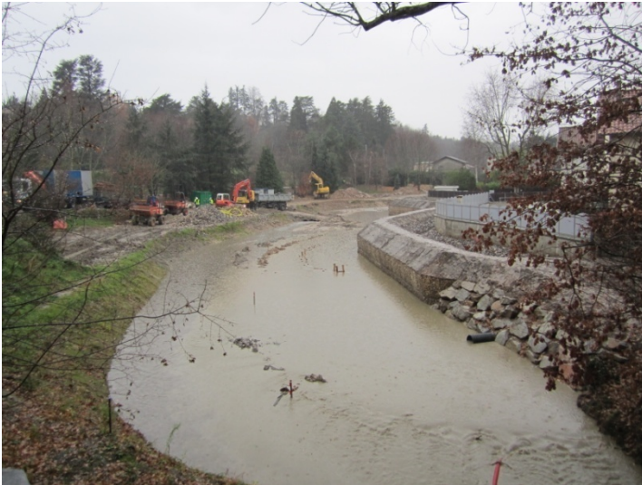
Crue du 26 novembre 2012
