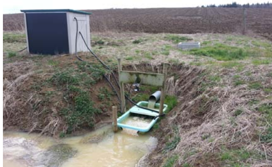
Vue sur la sortie de drain et la parcelle drainée
